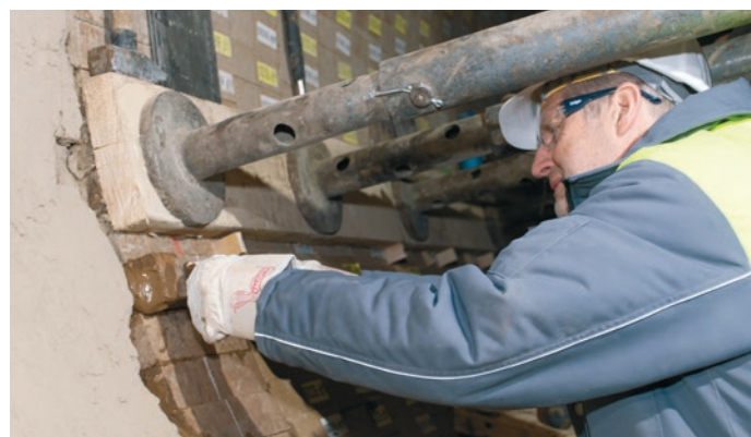
Schlussstein einer rekordverdächtigen Reparatur: Werksleiter DI Christian Breitenbaumer setzte fachgerecht den letzten Stein.
