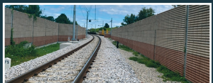
Lärmschutz im Aufwind: 40.000 m 2 -Installation zwischen Marburg und Graz.
