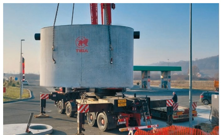
Ölabscheider für Tankstellen: Die gigantischen Behälter kommen nun auch bei der slowenischen PETROL-Gruppe zum Einsatz.
