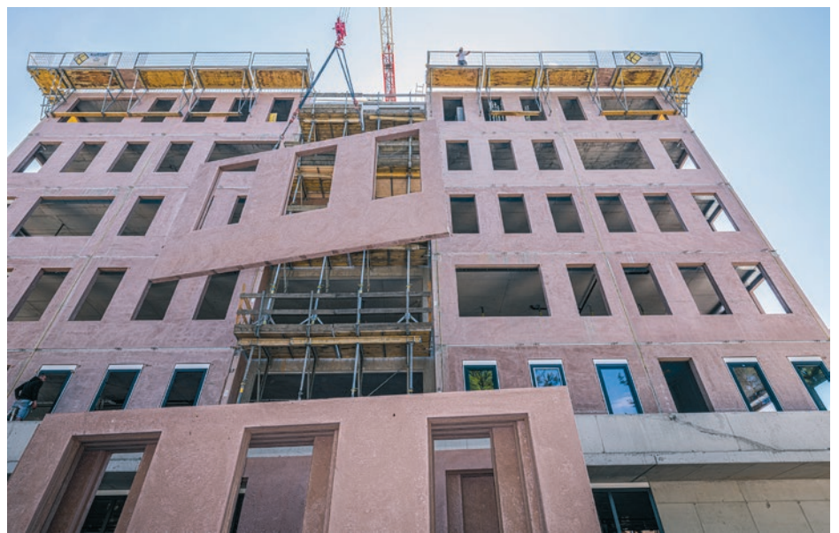
Office-Tower mit bestem Betriebsklima: Der UNIT-Tower, ein siebenstöckiges Büro- und Geschäftsgebäude in Gleisdorf, wurde mit 2.300 m 2 Ziegelt-Fertigteilwänden sowie Fertigteiltreppen und Balkonplatten umgesetzt. Pro Geschoß waren nur jeweils drei Werkstage erforderlich!
