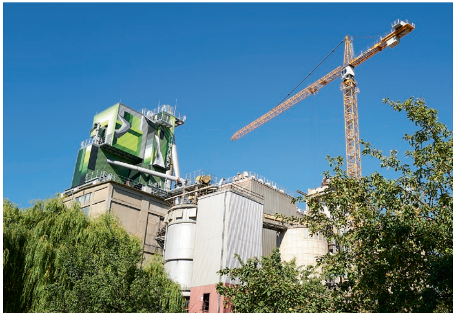
Gut, besser, effizienter: Ein Kran gehört im Kirchdorfer Zementwerk schon fast zur Grundausstattung. Laufend werden neue Anlagen dazu gebaut, die die bereits eindrucksvolle Einsatzrate an alternativen Brenn- und Rohstoffen kontinuierlich weiter erhöhen.
